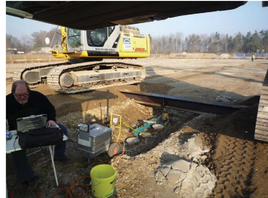
Bild 11 Versuchsaufbau für den in Bild 10 dargestellten Belastungsversuch. (vergrößerter Abstand der Totlast auf ca. 2,5 m zur Probesäule)
